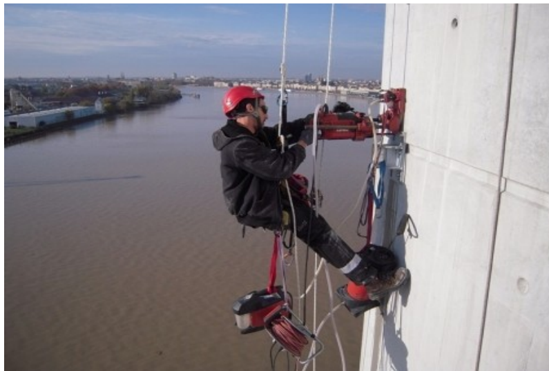
Manu, de la société Adrénaline 33, "accroché" à l'une des piles du Pont © Radio France
